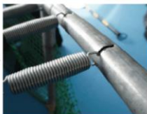
孔が拡がり危険な状態
